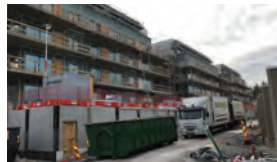
Isoenergi har mange store prosjekter for forskjellige bygg-entreprenører
